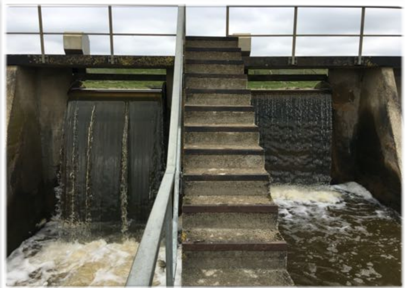
Waterinlaat aan de Noordermeerdijk tussen Rutten en Lemmer.
